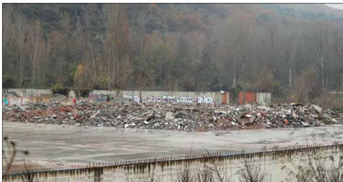
Los escombros se acumulan en la margen derecha del Sil, a la altura de la calle Soria. L. DE LA MATA
